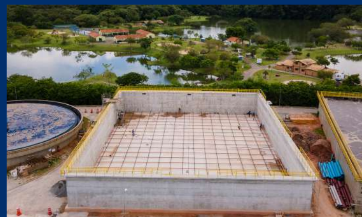
SISTEMA DE AERAÇÃO
