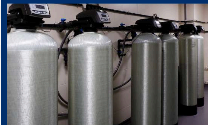
SISTEMA DE FILTRAGEM
