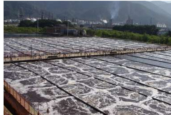
Cliente: Petrobras Local: Cubatão - SP
