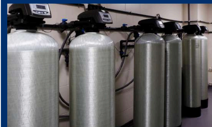
SISTEMA DE FILTRAGEM
